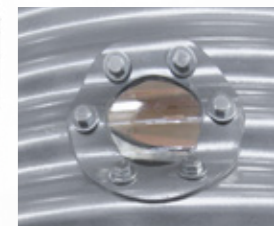
czujniki zasypu silosu
